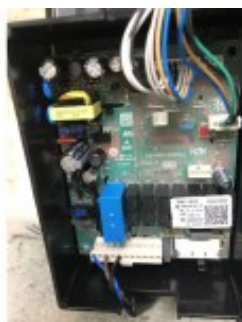
CW 400 - MAIN PCB BOARD NEL VANO MOTORE CZE301AZ4000001
